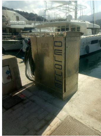
Figura 98: Bomba de aspiración de aguas de sentina en Port de Soller.
