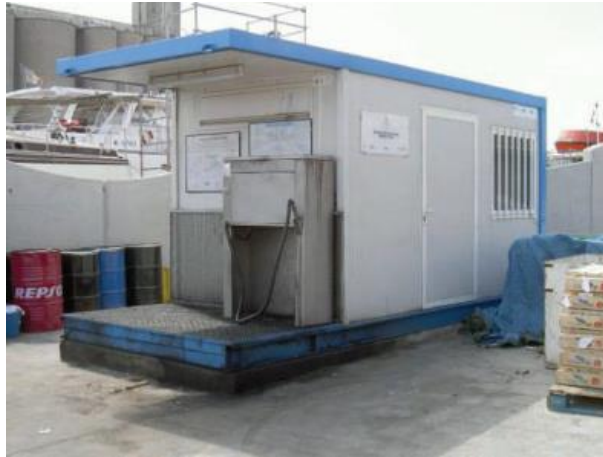
Figura 178: Módulo de almacenamiento de aceites en el punto limpio del puerto de Tarragona.
